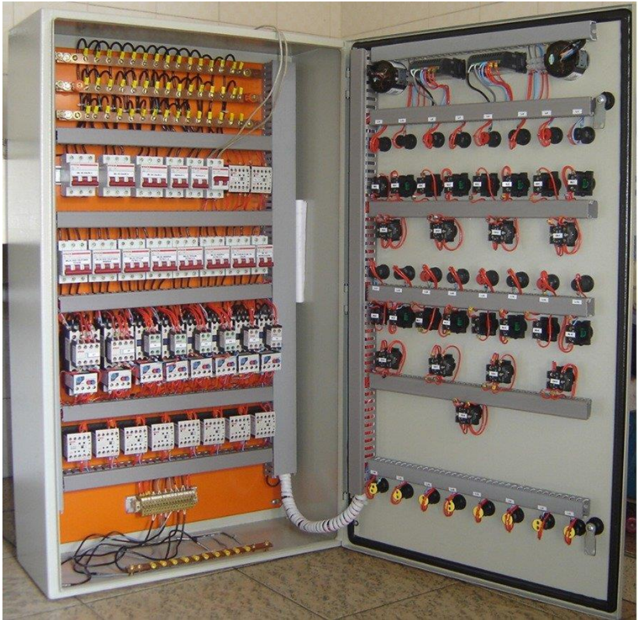
Painel de comando e proteção
